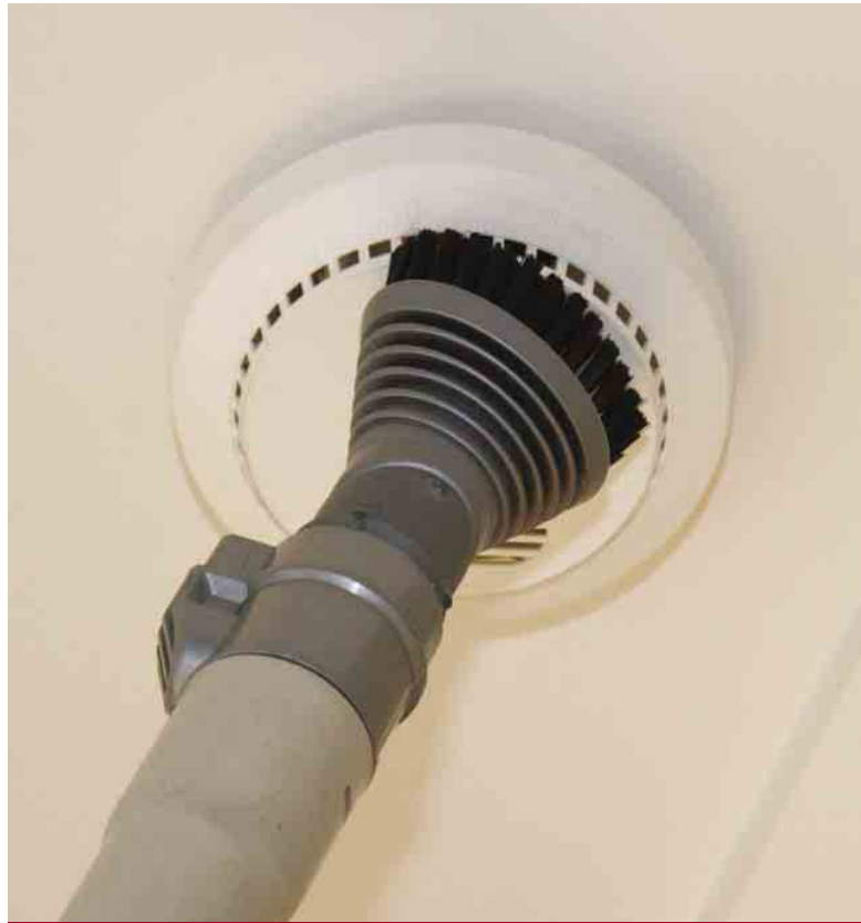
掃除機で火災警報器の埃をとってください
