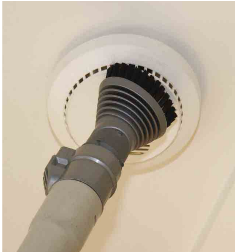
Spolvera l'allarme antincendio con l'aspirapolvere
